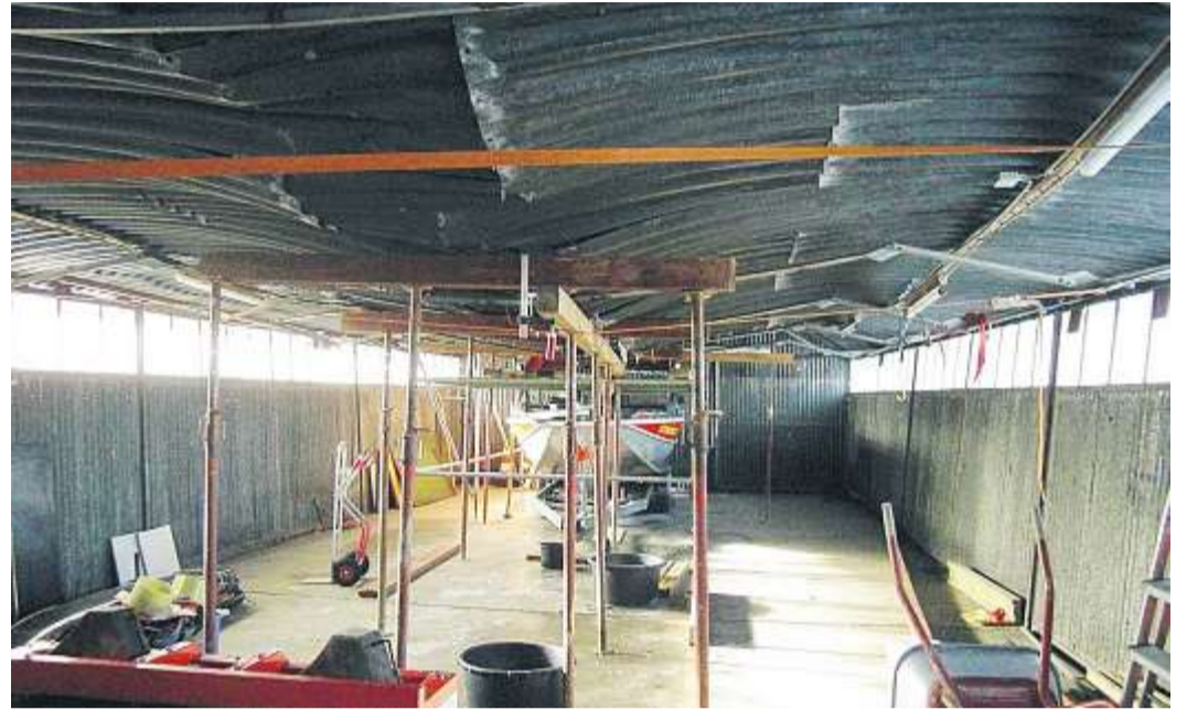
Das Dach der DLRG-Halle wurde völlig zerstört.
